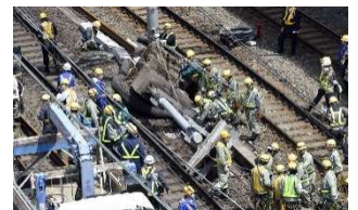
山手線架線柱倒壊 (2015)
