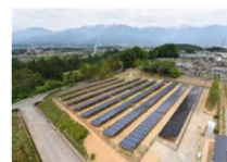
リユース品を使用した発電所
