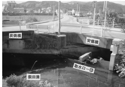
てんとうせき 転倒堰 (取水口—⑬) ここより分かれて安徳橋下をくぐり、「古河」へと流れ込み、現人橋上流で那珂川と合流します。
