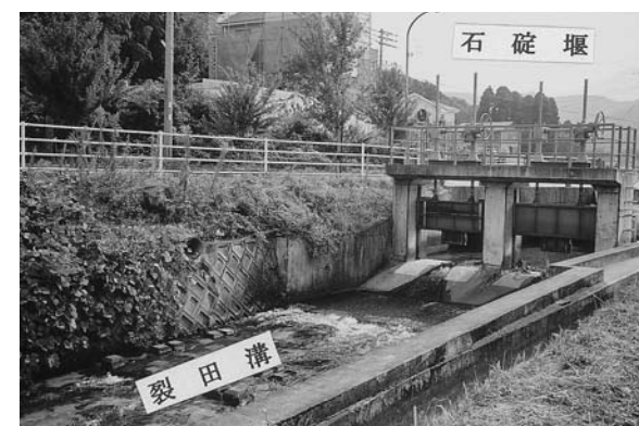
石碓堰／平成7年に設置。鋼製スライドゲート。幅5.45m、高さ2.4m
