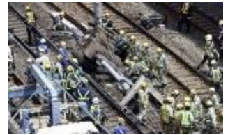
山手線架線柱倒壊 (2015)
