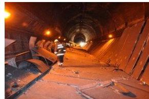
笹子トンネル天井板落下事故 (2012)
