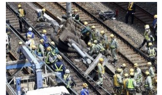
山手線架線柱倒壊 (2015)
